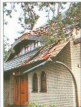
Dachschaden an der Marienstraße: Teile flogen bis zu 20 Meter weit.
